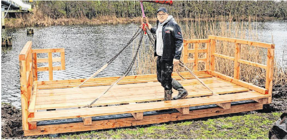
Zimmermann Frank Thiel bei der Installation der rund zehn Quadratmeter großen Plattform.
